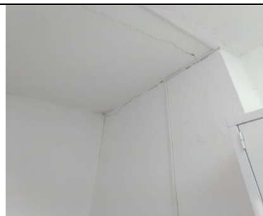
Trinca de junção na cozinha
