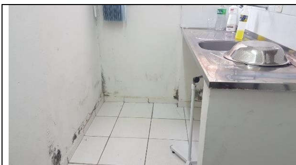
Umidade presente na sala de expurgo
