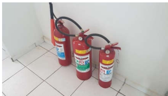
Sistema de combate e prevenção a incêndio irregular
