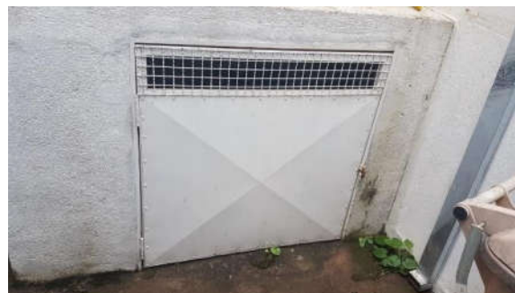
Portão do compressor
