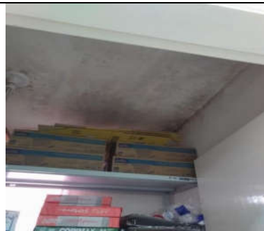
Umidade Presente no teto do almoxarifado
