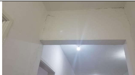
Trinca de junção no corredor
