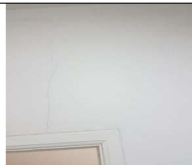
Trinca sobre a porta do consultório geral
